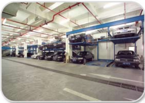
上海景鸿大厦 升降横移式 悬臂式 70车位 Shanghai Jinghong Mansion Lift-sliding parking system—having 70 parking seats
